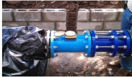
Medidor de caudal
